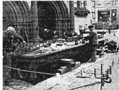
Die Lohrer Stadtwaage musste vor 50 Jahren repariert werden. Foto: Hans Lembach
